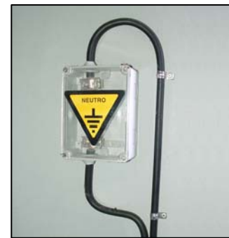
Figura 3.13: Caja de Seccionamiento de Neutro
