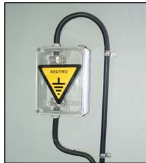
Figura 1.7: Caja de Seccionamiento de Servicio
